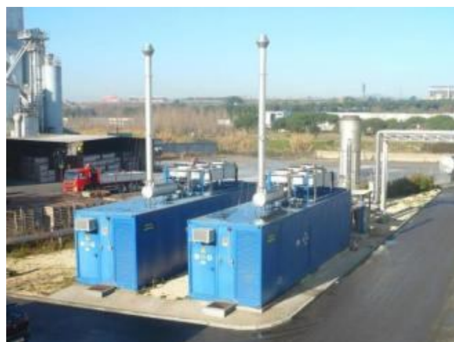
Motors de cogeneració
