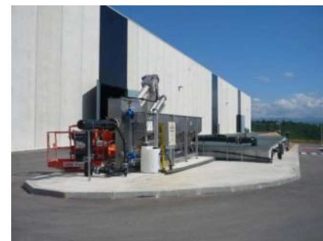
Depuració d'aigües de procés
