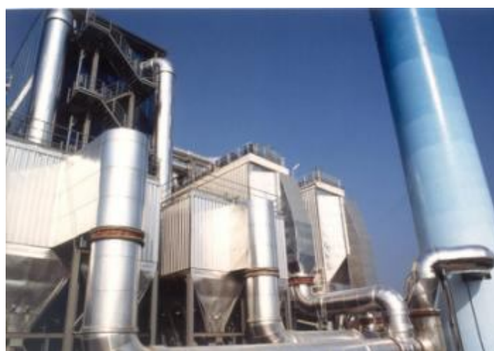
Filtres de mànegues i equips depuració gasos
