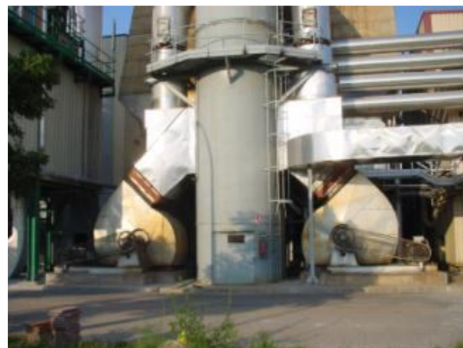
Ventilador tiratge forns
