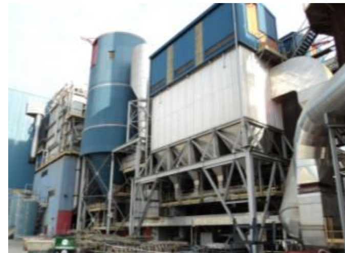
Equipaments de depuració de gasos
