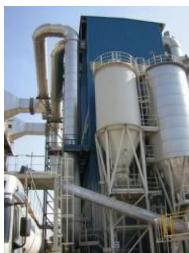
Equips depuració de gasos
