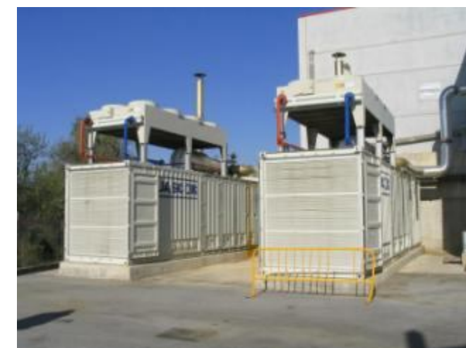
Motors de cogeneració
