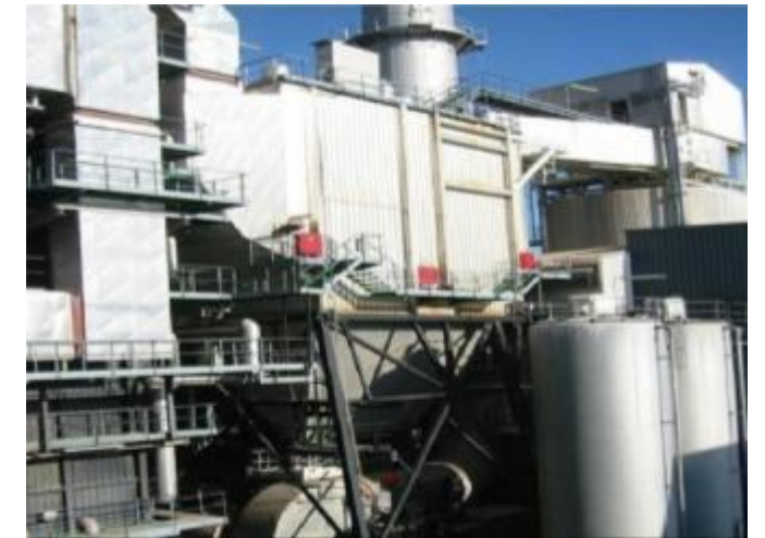
Equipament depuració de gasos
