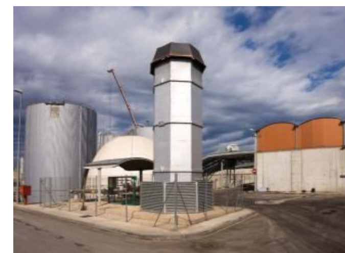
Equips biogàs biometanització
