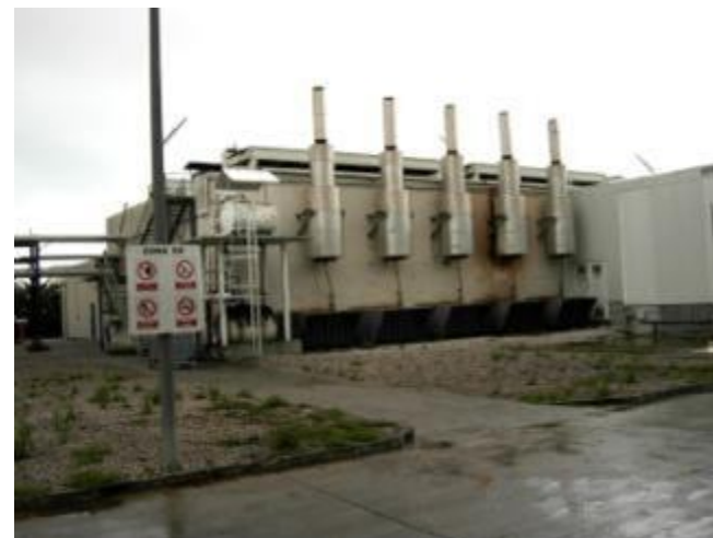
Àrea de cogeneració
