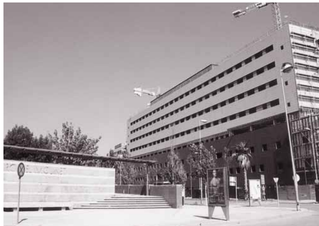
En la foto de arriba, Marina Geli y Bartomeu Muñoz comprueban el estado de las obras del nuevo hospital; abajo, la fachada del edificio.
