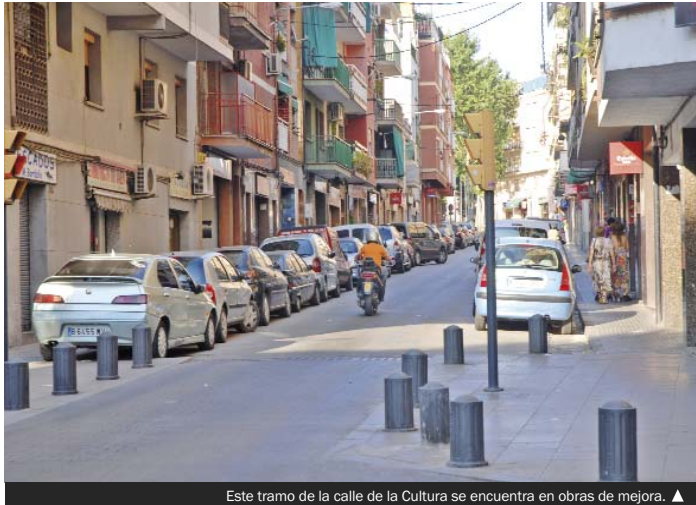
Este tramo de la calle de la Cultura se encuentra en obras de mejora. ▲
