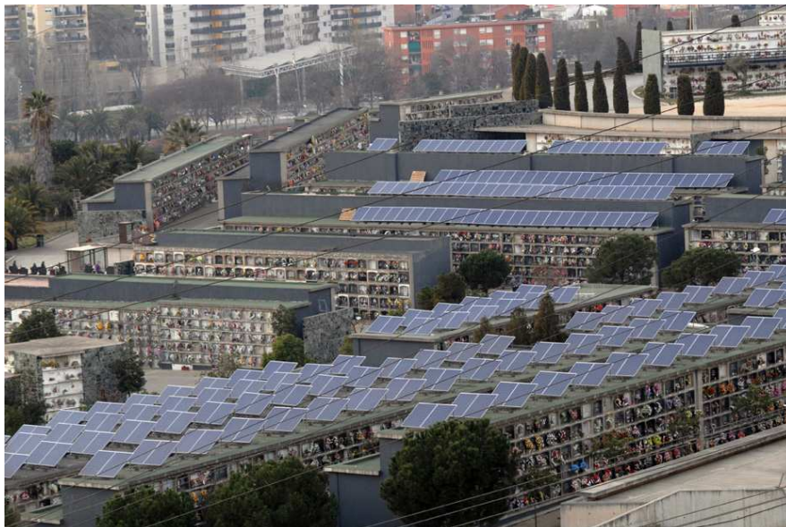
+ Vista actual del parc solar del cementiri municipal de Santa Coloma
