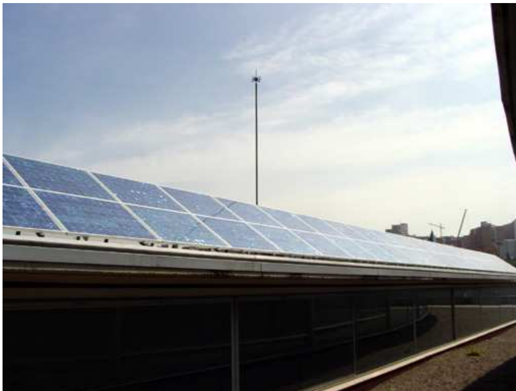
Les plaques solars estan ubicades al sostre de la Biblioteca Central
